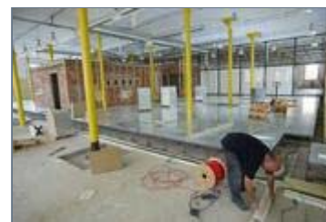
+ Treballs d'adequació de la biblioteca d'adults, a la planta baixa de la nau Kropotkin, que conserva les antigues columnes de la fàbrica, i una de les façanes del complex. Foto: MANEL LLADÓ
