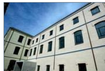
+ Treballs d'adequació de la biblioteca d'adults, a la planta baixa de la nau Kropotkin, que conserva les antigues columnes de la fàbrica, i una de les façanes del complex. Foto: MANEL LLADÓ
